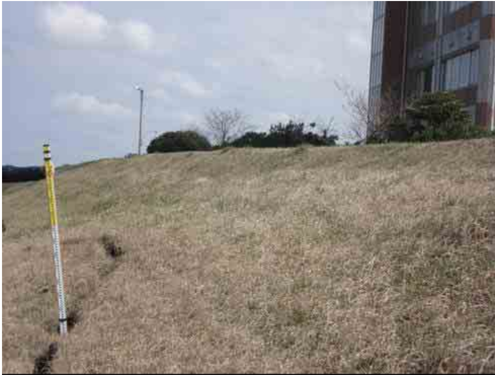
図-16 堤防法面（川表側）の亀裂（深さ 1m を超える規模）
