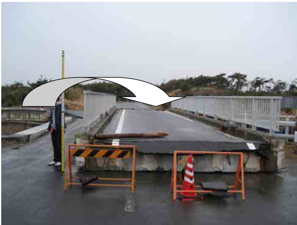
図-7 パターン4：砂丘開口部（野中川）の状況：遊歩道・自転車同様の橋桁が持ち上げられ、隣の道路橋の上に落下している。
