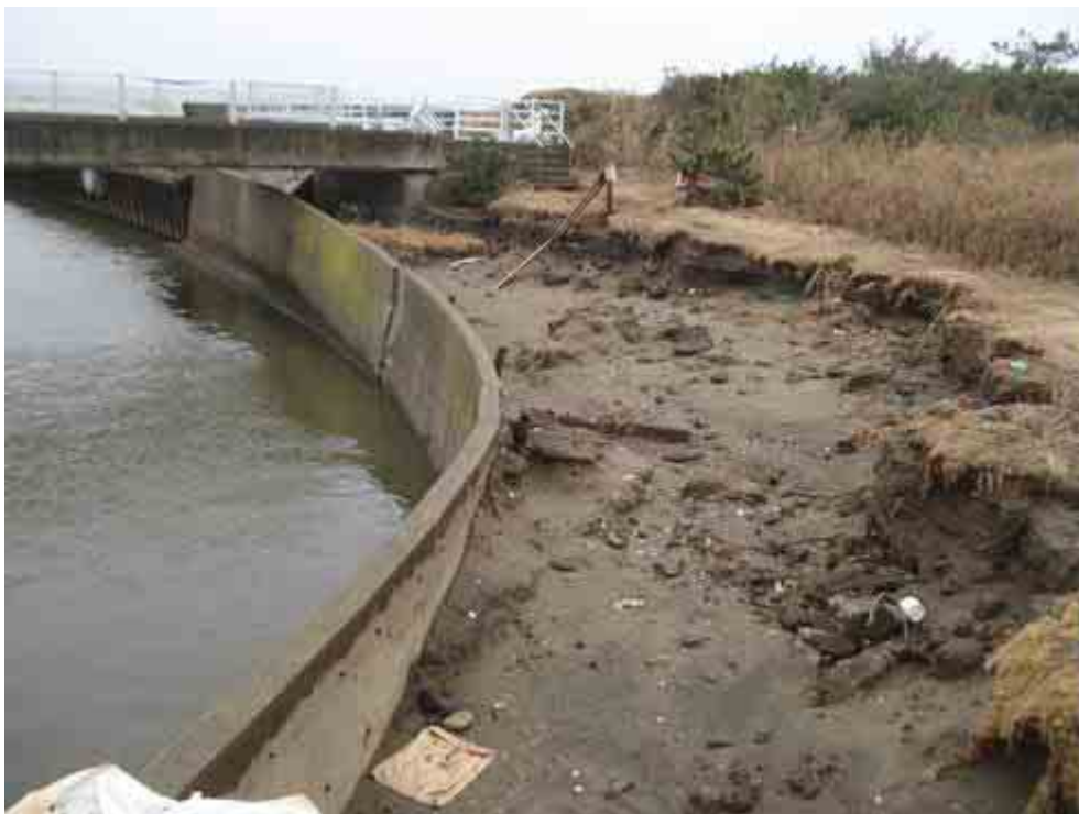
図-9 パターン4：砂丘開口部（三川）の状況：擁壁裏側の洗掘
