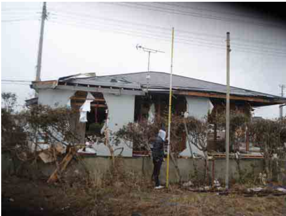
図-11 パターン4：砂丘開口部（三川）の周辺家屋の破壊状況
