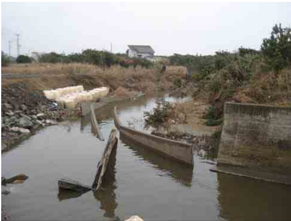
図-10 パターン4：砂丘開口部（三川）の状況：擁壁の破壊
