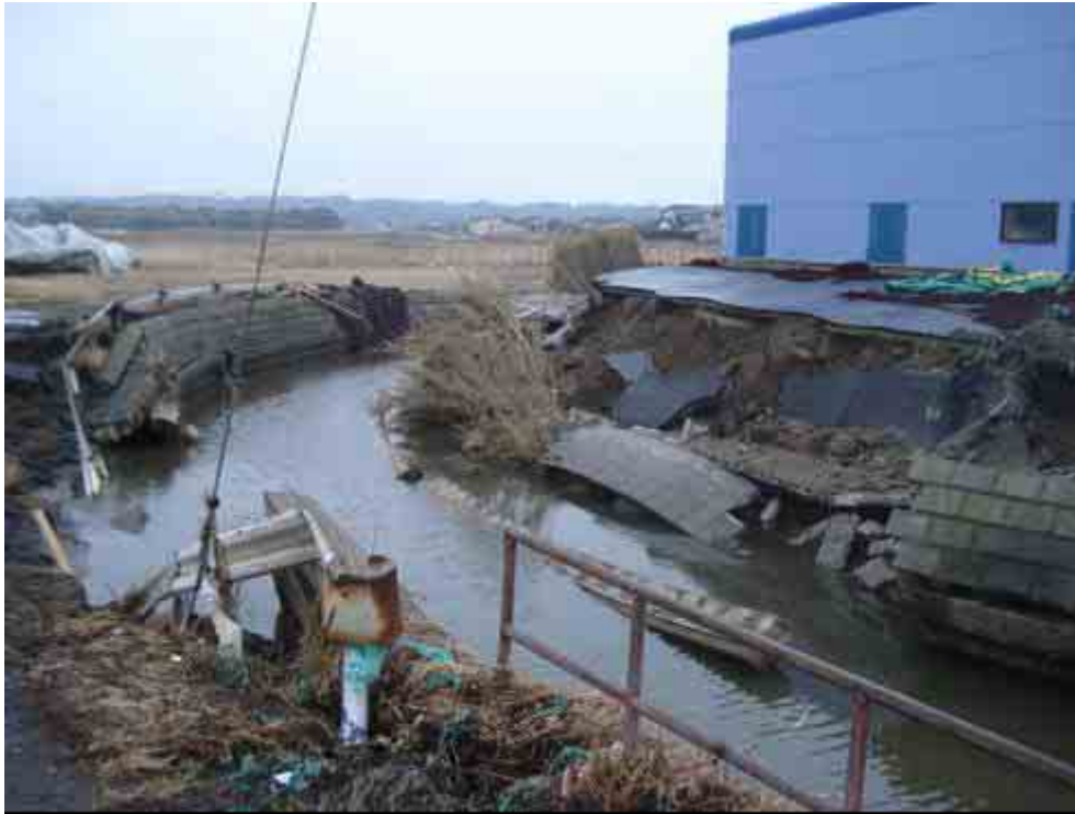
図-12 パターン4：砂丘開口部（三川）の破壊状況
